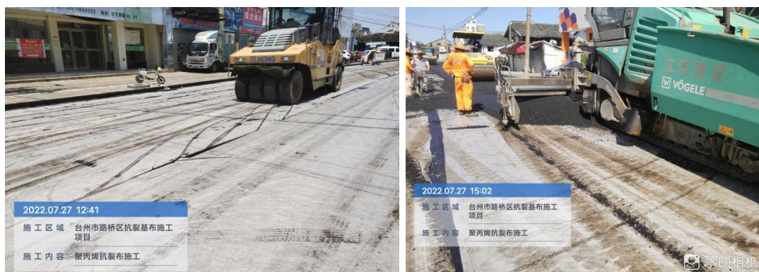
图 10 浙江台州路桥区卖芝桥鹿项目
